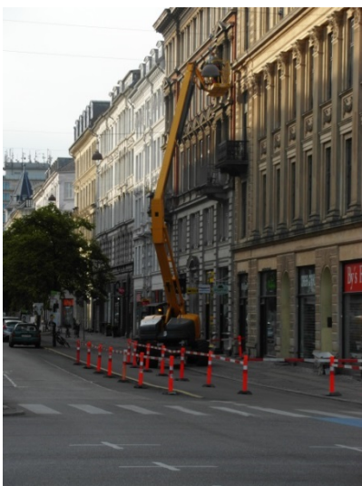
Figur 4.7 Eksempel på ikke-indregistreret mobillift i afspærret arbejdsområde på vejareal
